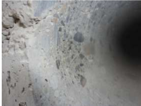
شکل ۷- (نمایی از چسبندگی بین دو لیفت بتن ریزی)
