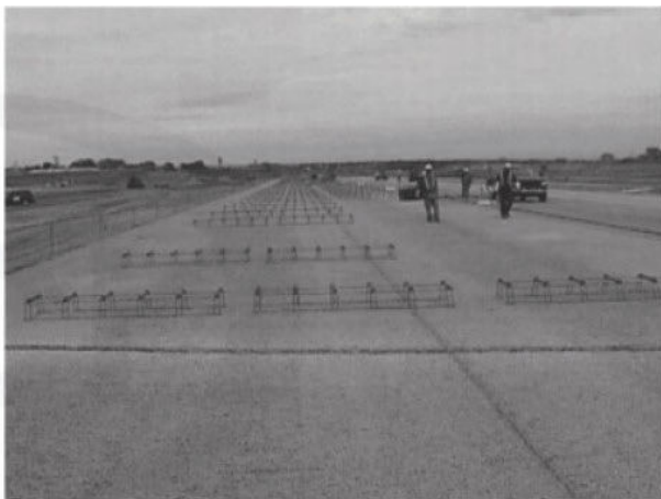
شکل ۳-۳-۲- لایه اساس بتنی تراوا پیش از روسازی بتنی متعارف در فرودگاه بین‌المللی Lambert
