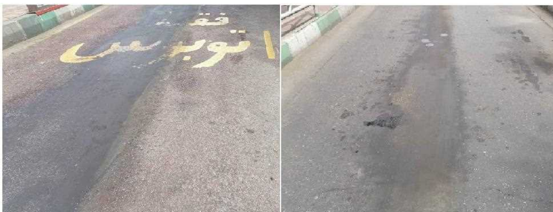
شکل شماره ۲: خرابی rutting یا شیارشدگی در خط شماره یک BRT (عکس از نگارندگان)
