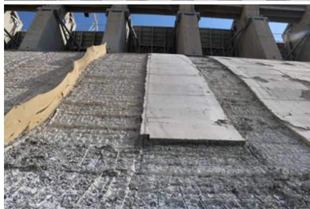
شکل ۸- تخریب بتن آسیب دیده سرریز سد
