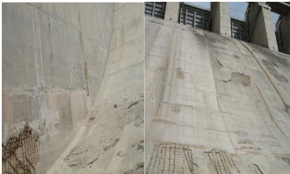
شکل ۷- خرابی بتن سد استقلال میناب
